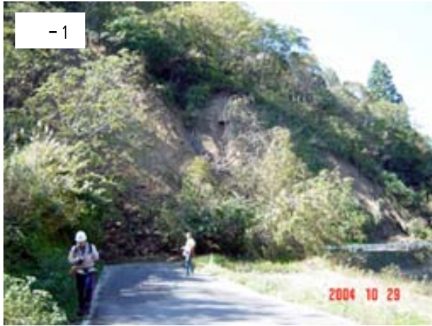
野辺川沿いの山道の数箇所は、斜面崩落による崩土で塞がれている。
