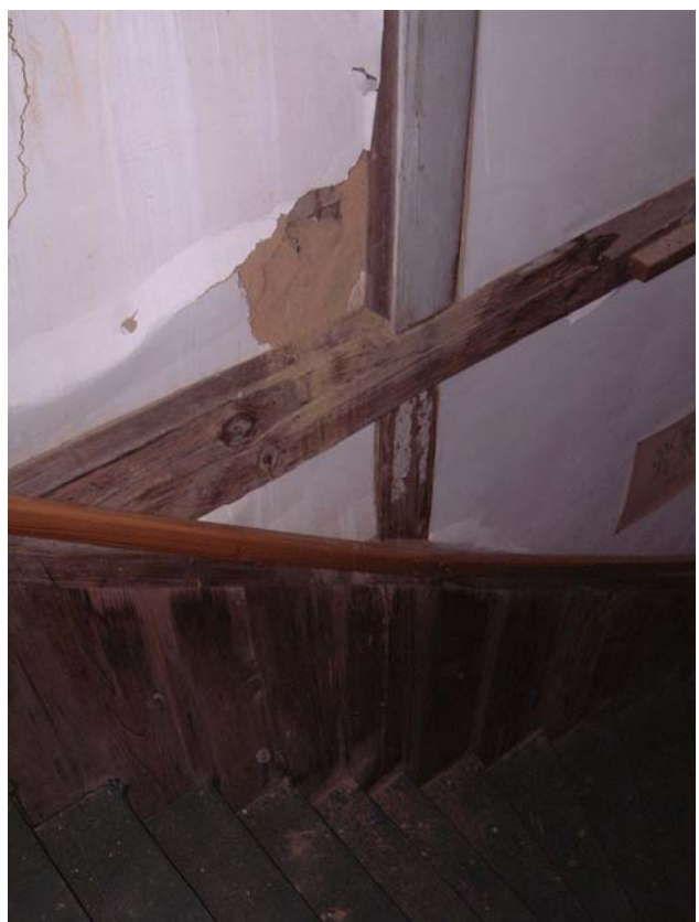
③壁面表面のたわみと剥離の進行（階段横壁面）
