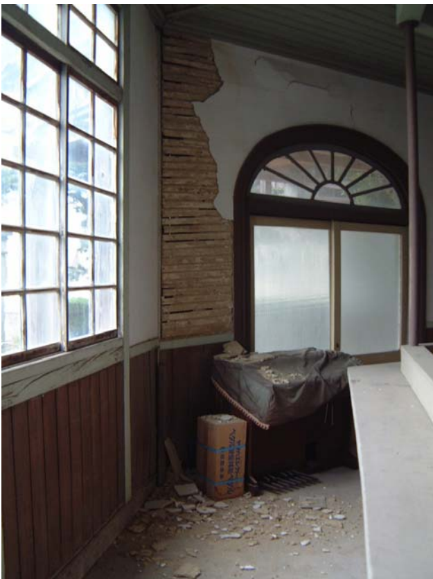
②壁面の剥離・崩落（正面玄関内側）
