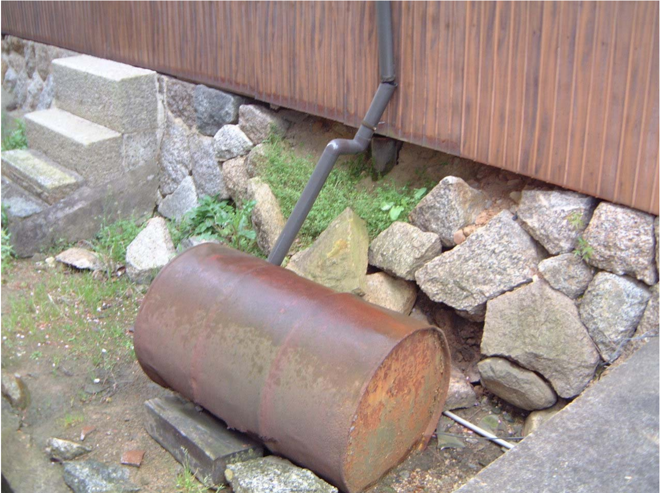
①建物基礎の石垣の一部崩壊（北東隅近く）
