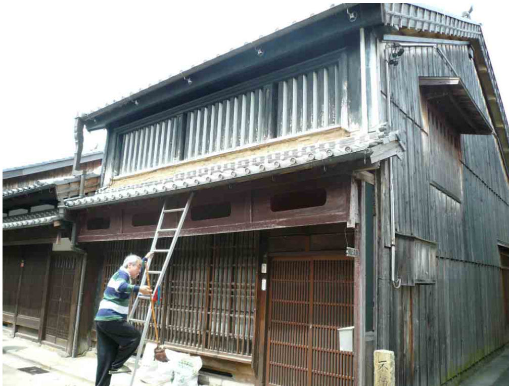
伝建北152（亀山市関町木崎555） 漆喰壁の剥離・落下
