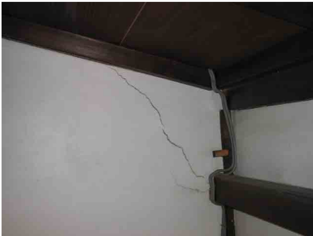
伝建南123 関まちなみ資料館(関町中町482) 内部壁の損壊
