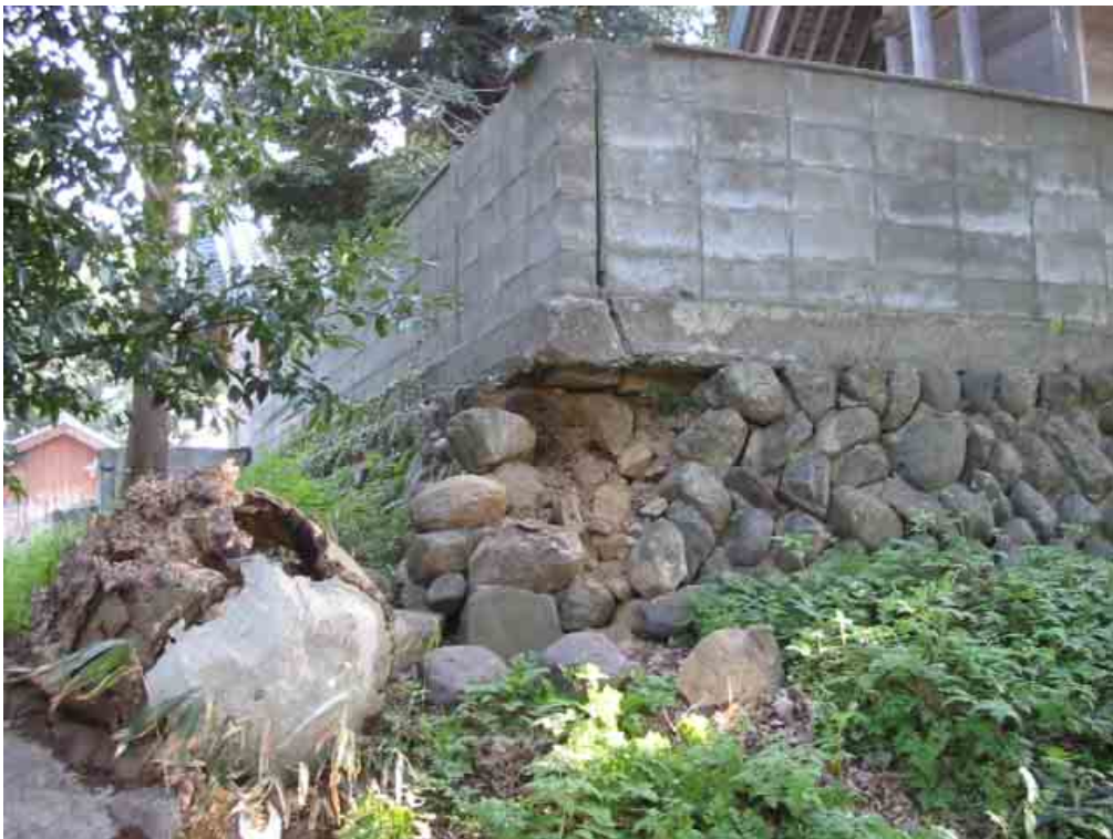
関神社（関町木崎675）石造物（石垣）の損壊
