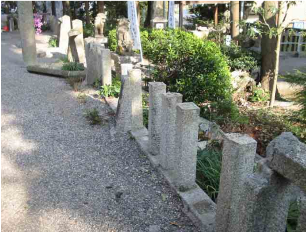
関神社（関町木崎675）石造物（石柵）の損壊
