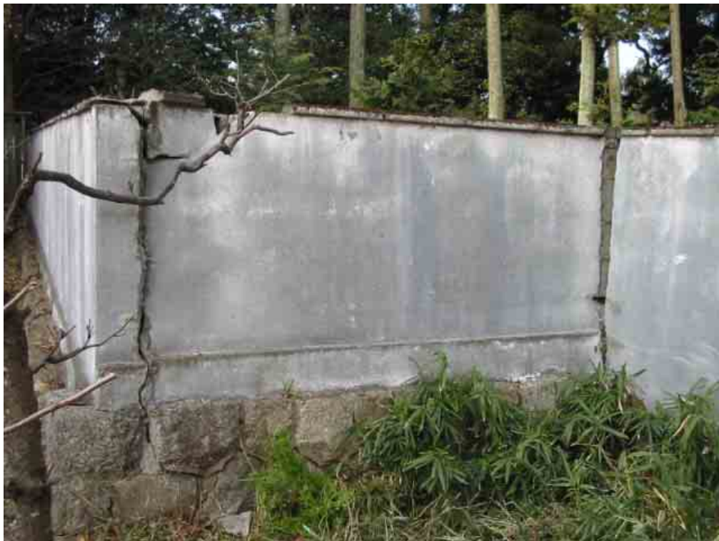
関神社（関町木崎675）石造物（塀）の損壊
