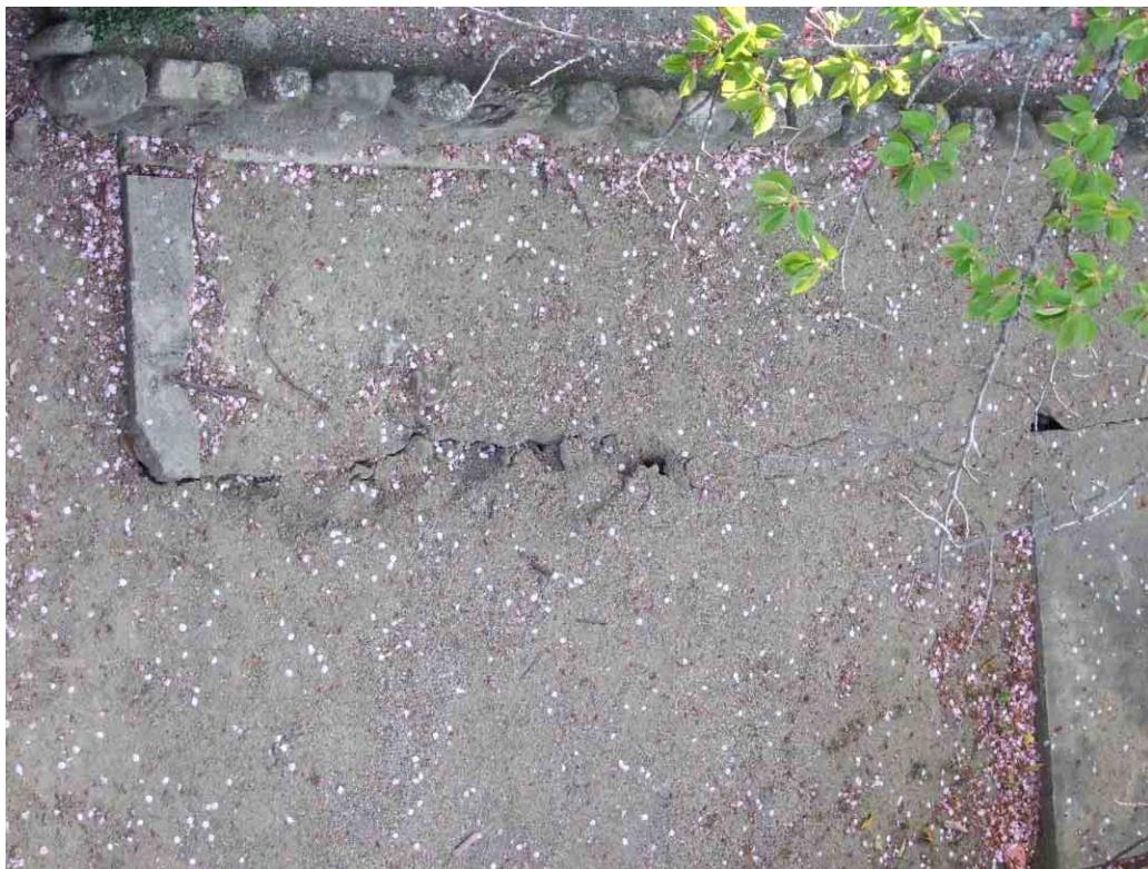
旧亀山城多門櫓 周辺部における地面の亀裂
