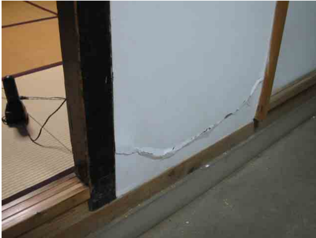
伝建北120 (関町中町474-1) 内部壁の損壊
