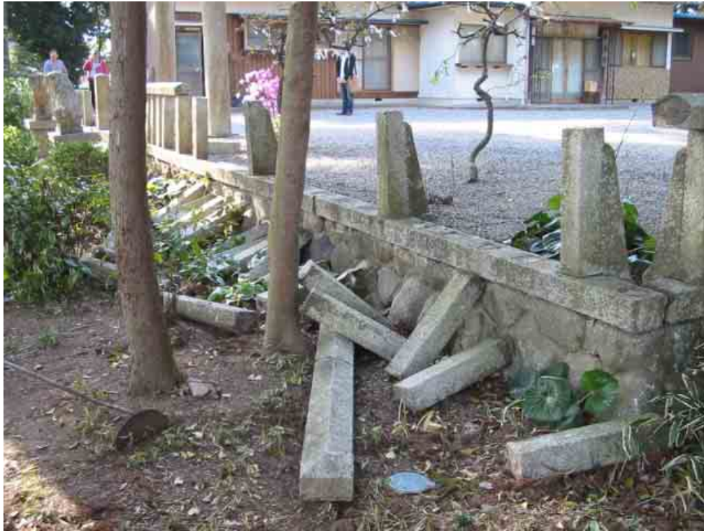
関神社（関町木崎675）石造物（石柵）の損壊
