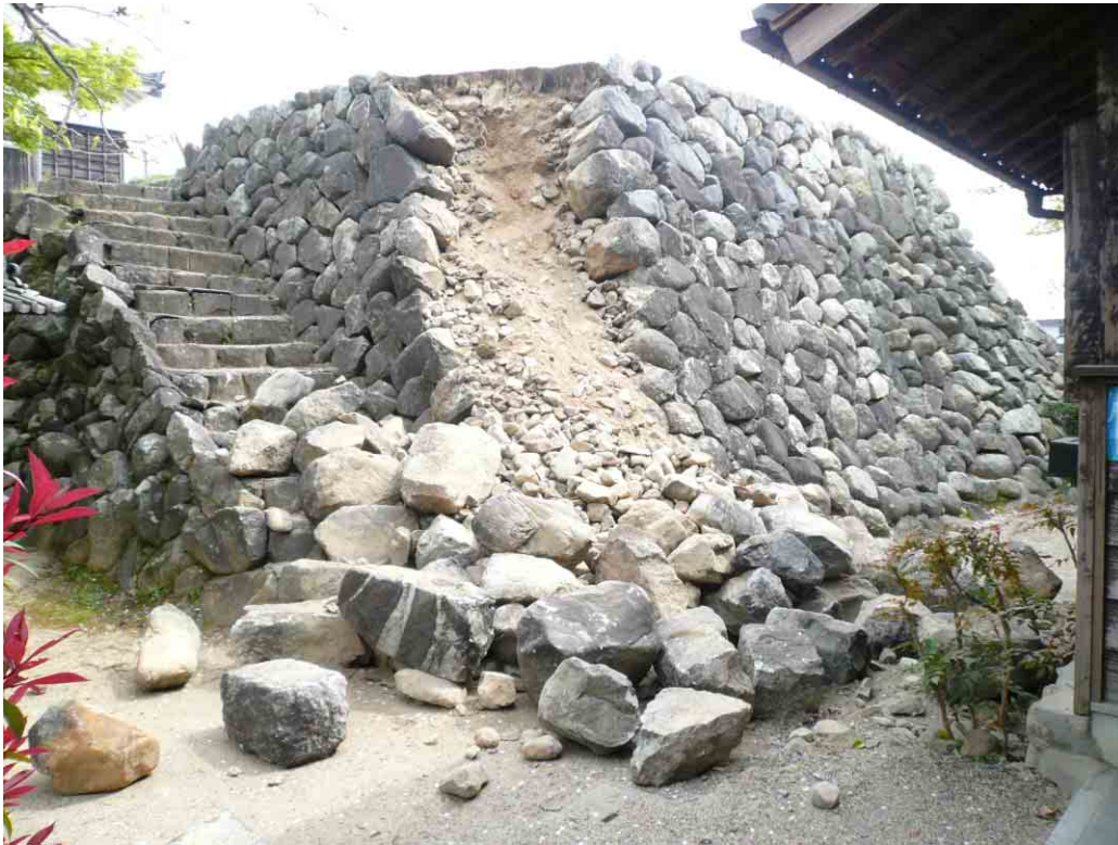
旧亀山城多門櫓 石垣西北出隅の崩落（幅2m 高6m）
