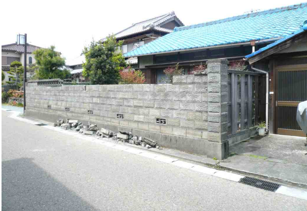
非伝建北156（亀山市関町木崎1571） ブロック塀の落下
