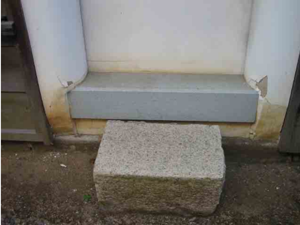
伝建南 1 2 3 関まちなみ資料館（関町中町 4 8 2 ） 土蔵壁の損壊
