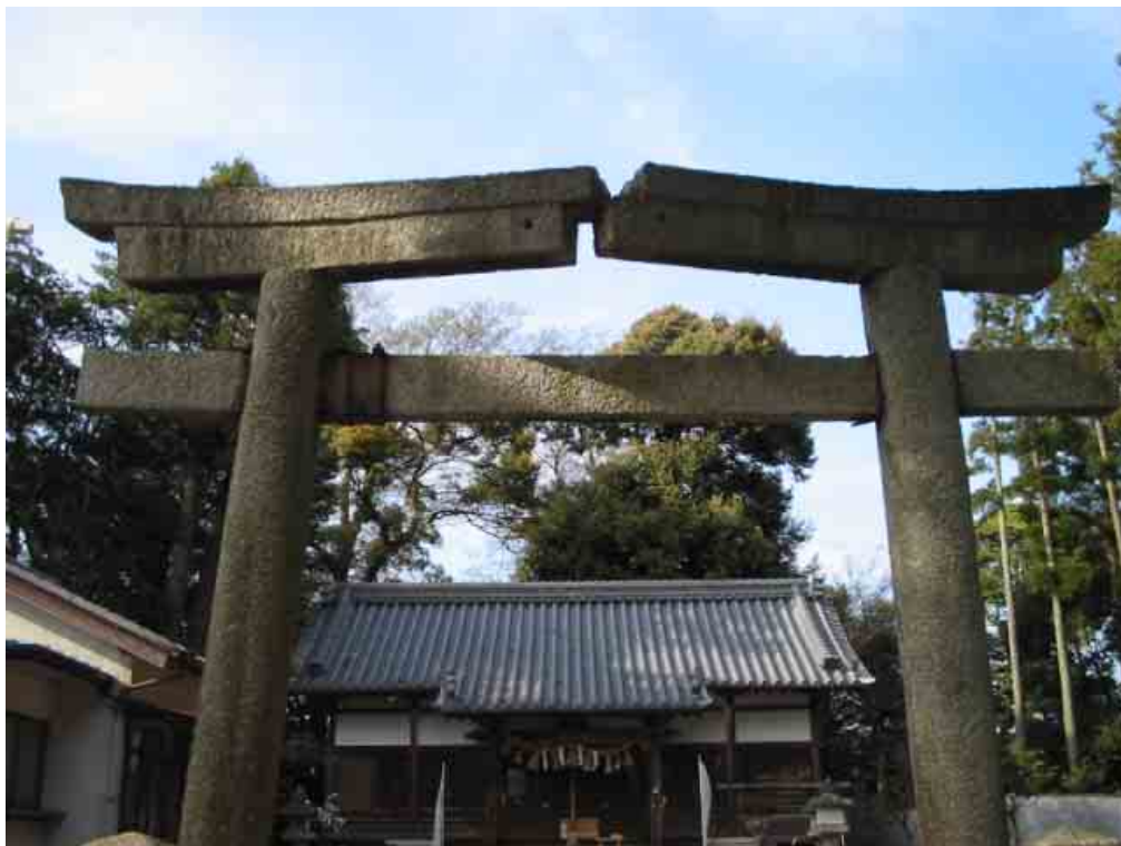
関神社（関町木崎675）石造物（鳥居）の損壊 細部
